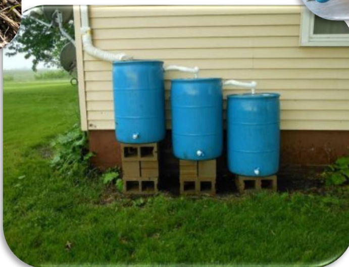
Récupération des eaux pluviales
